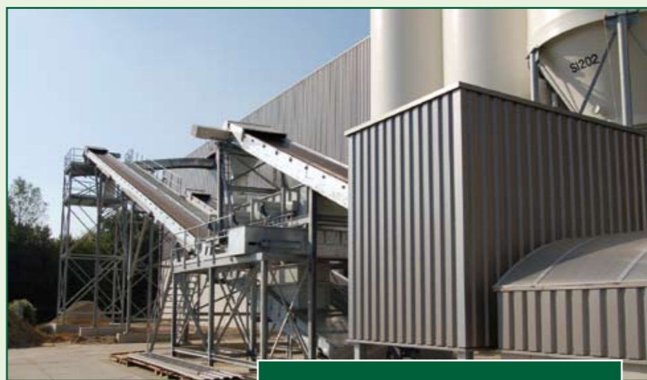
Transportbanden voor transport van fijner materiaal naar opslagvakken binnen. Deze worden nog overkapt. Rechts zijn de silo's zichtbaar
