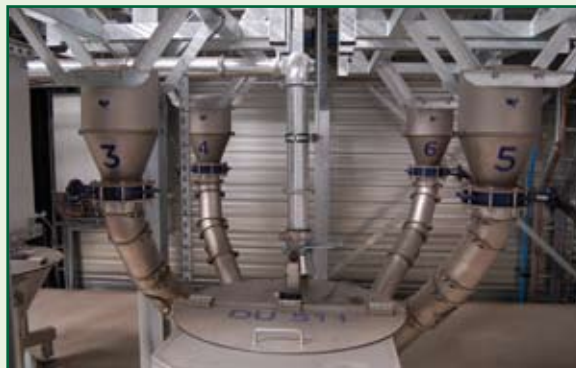
Deel van de doseerinstallatie met aansluitmogelijkheid van vier bigbags in combinatie met stortkabinet
